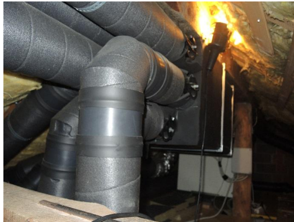
Slika 2: Izvedba sistema na podstrehi.
