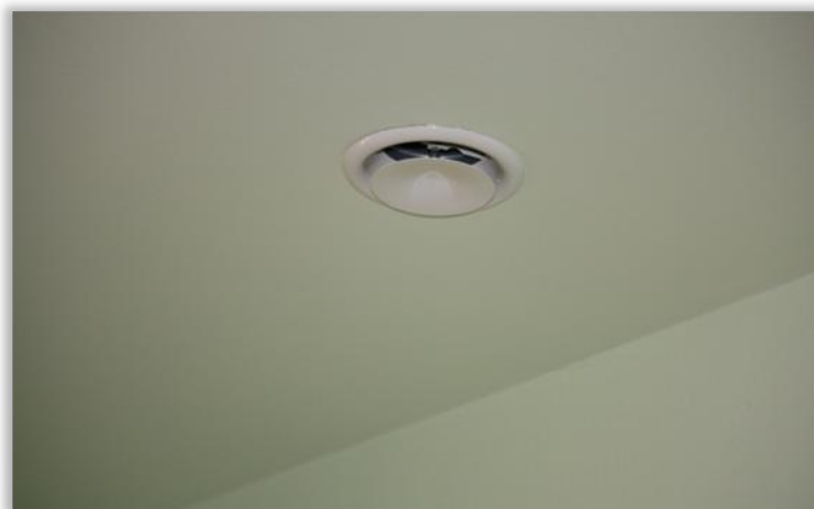
Slika 3: Vpihovalna rešetka na stropu mansarde.
