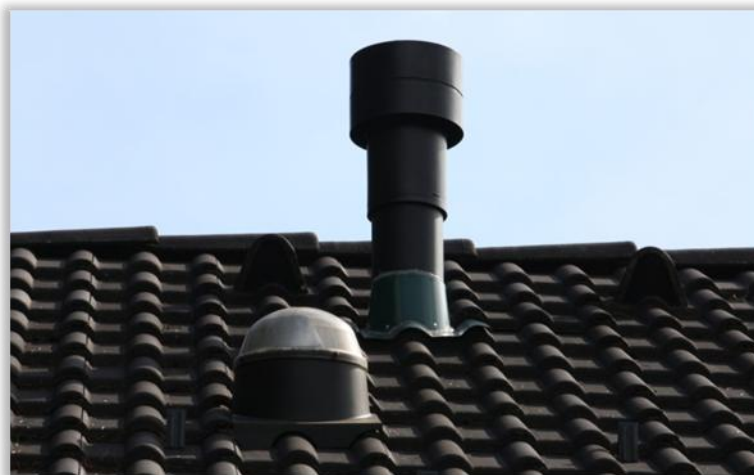
Slika 4: Izpih odpadnega zraka čez streho.
